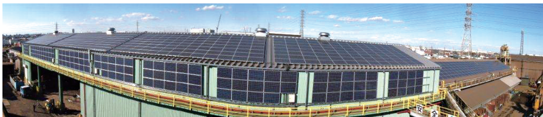
▲全長200mの第一工場屋根と壁面に設置された太陽光発電システム・ソーラーパネル
